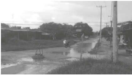
Figura 5.2 Calle de Leticia con problemas en la estructura vial, red de alcantarillado y en el drenaje de aguas lluvia
